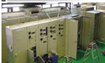
排水処理設備
